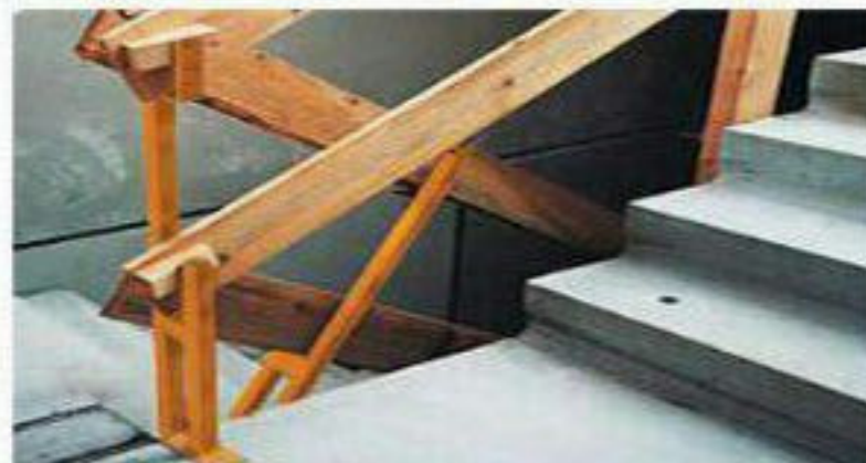
▲ نرده گذاری حفاظتی مناسب در راه پله ها- دوران ساخت
