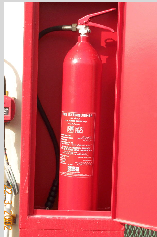
CO2 Type Extinguisher
